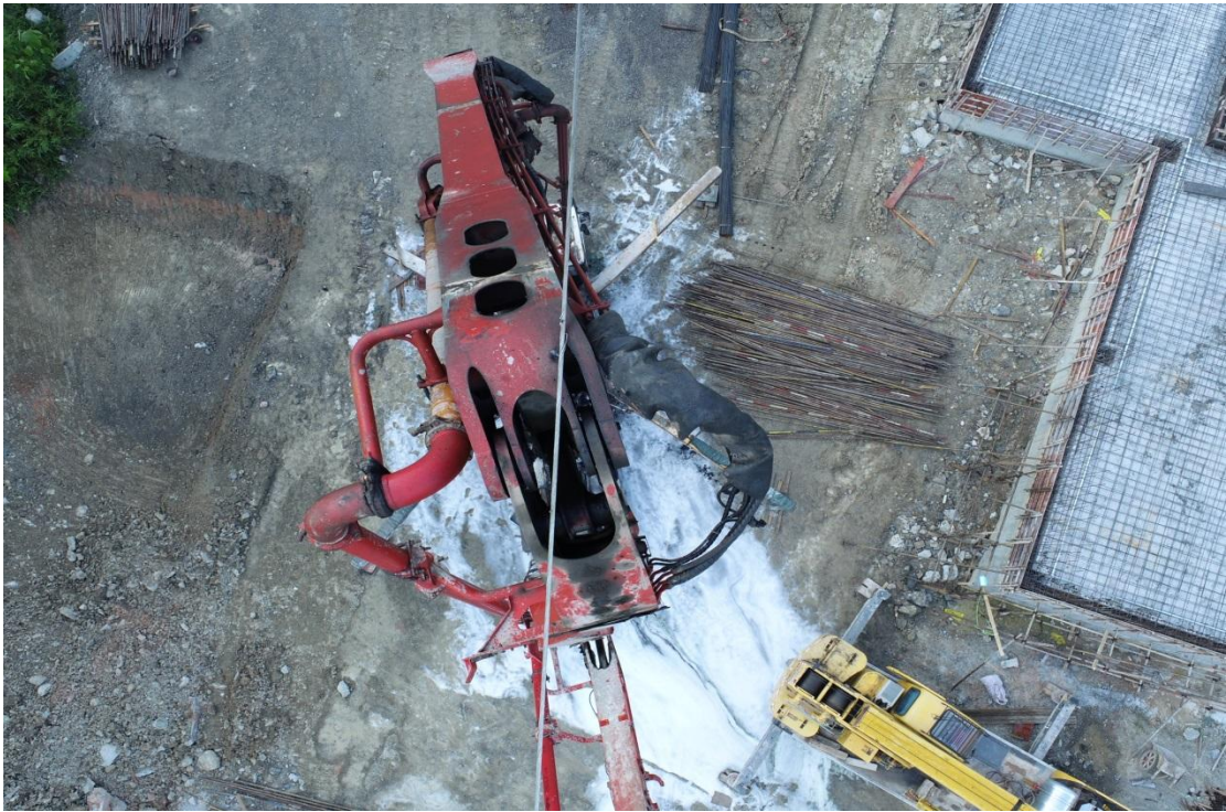
俯视图（白色泡沫为消防灭火残留物）
