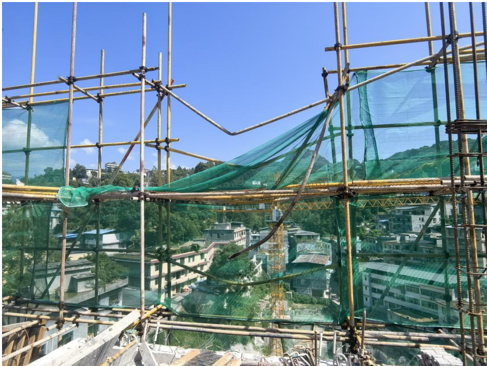
图一：12层被吊运的钢管掉落砸弯的外架钢管架
