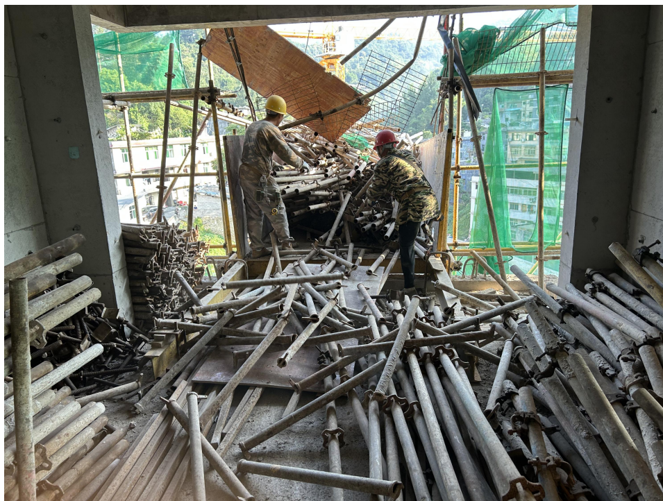
图二：掉落在 9 层卸料平台的钢管
